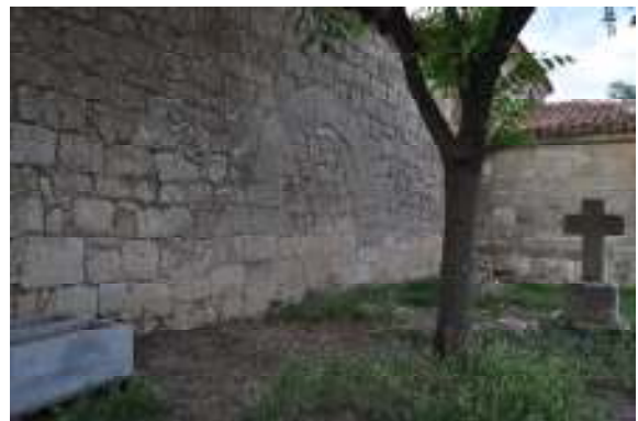
Lateral sur, área sobre elevada. En este lateral existen restos de una portada que permitiría el acceso a la ermita.
