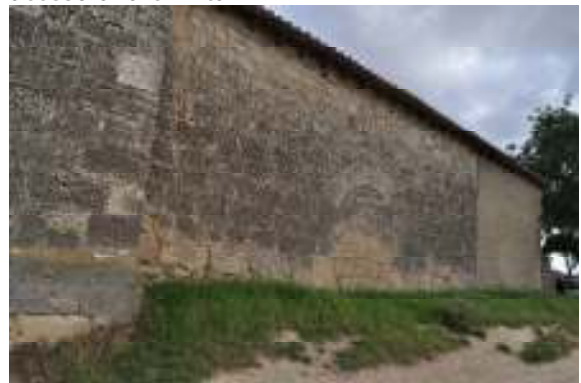
Lateral norte de la ermita. Zona sobre elevada, en el muro existe otra portada cegada. Obsérvese que el tercio delantero de la ermita es un añadido realizado en el último cuarto del siglo pasado.
