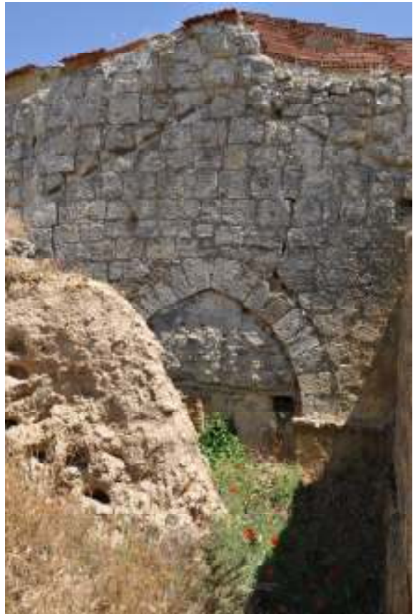
Vista de la fachada de la ermita y de la puerta de entrada, la cual está cegada y se ubica en el interior de la estructura aneja. Obsérvese como queda marcado, en la parte superior de la fachada, el primitivo tejado a dos aguas
