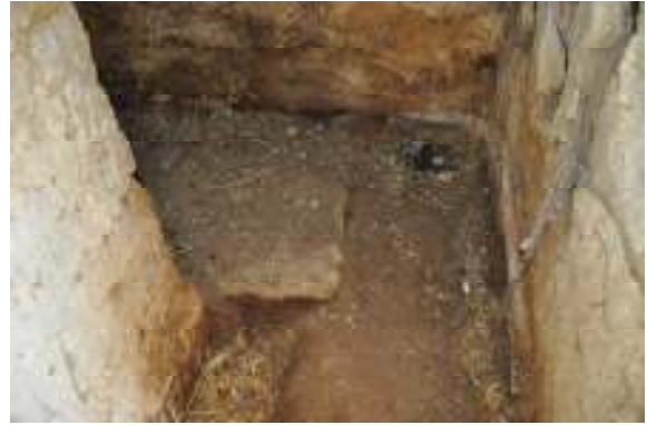
Suelos de losas de piedras calizas, posiblemente se trate del suelo original de la ermita.
